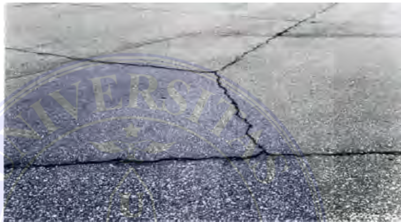
Gambar 29. Retak sambungan jalan, (Shahin 2003)
