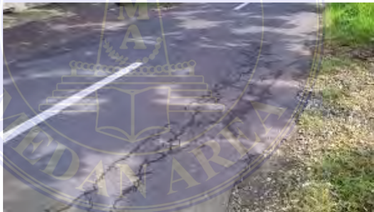
Gambar 44. Penurunan pada bekas penanaman utilitas, (Departemen Pekerjaan Umum Direktorat Jenderal Bina Marga)
