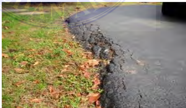
Gambar 28. Retak pinggir (Shahin 2003)
