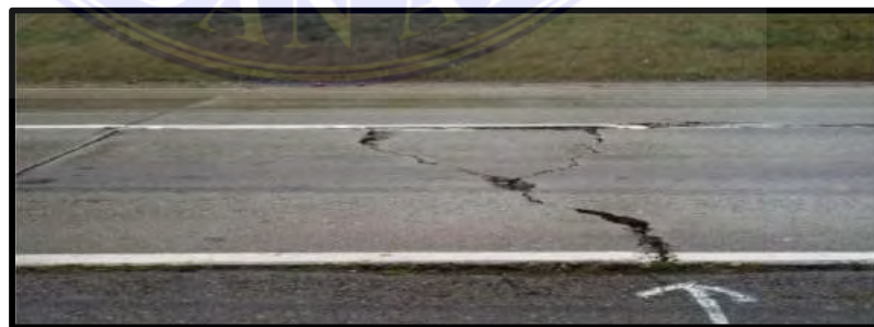
Gambar 5. Retak Sambungan Bahu dan Perkerasan ( https://dpu.kulonprogokab.go.id )
