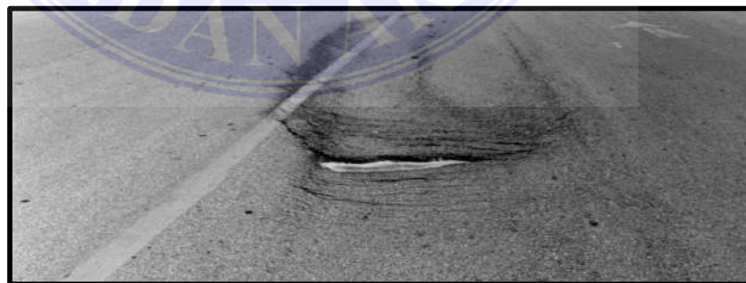
Gambar 11. Retak Selip ( https://dpu.kulonprogokab.go.id )
