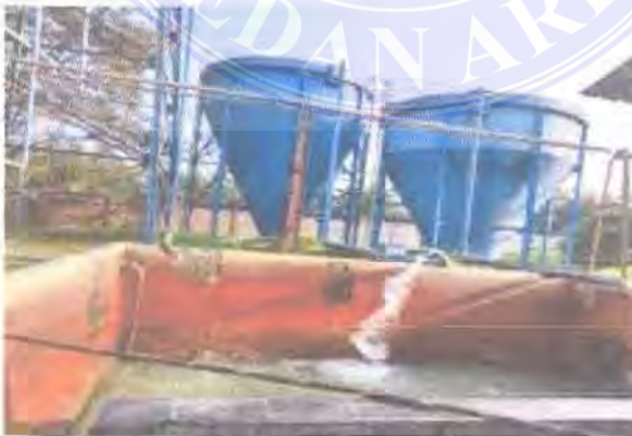
Gambar 3. 37 Clarifier Tank dan Bak Pengendapan
