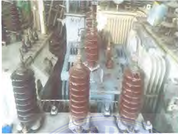
Gambar 3.2 Bushing pada Trafo terbakar
