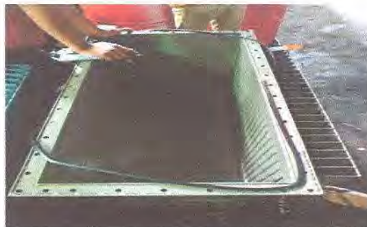
Gambar 2.4 Tangki Minyak Transformator
