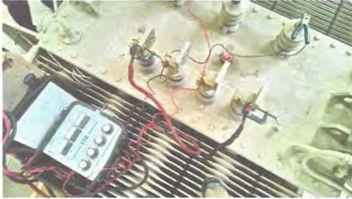
Gambar 3.6 pengecekan Trafo menggunakan TTR
