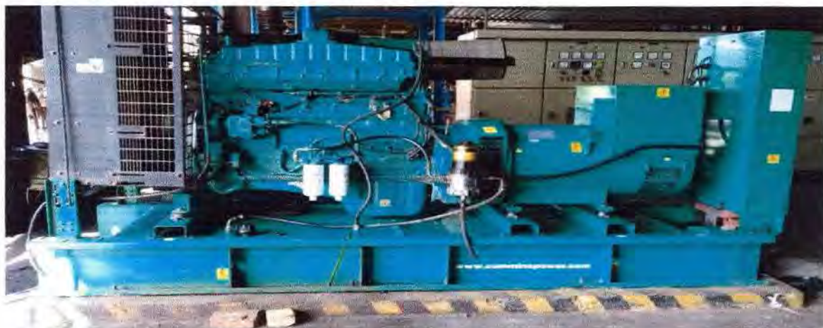
Gambar 5: Pembangkit Listrik Tenaga Diesel (Sumber : Penulis, 2020)
