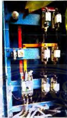
Gambar 4.1: Gardu Distribusi MT826 (Sumber: Dokumentasi Penulis)
