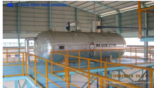
Gambar 3.6. Daerator Pemanas Air Umpan
