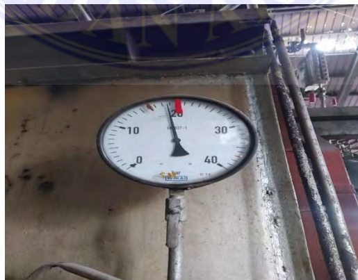
Gambar 3.9. Mengukur Tekanan Uap Boiler
