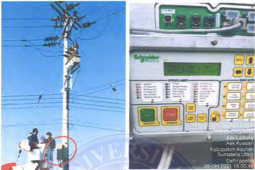
a. Recloser terpasang ditiang SUTM
