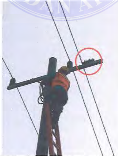
Gambar 3.3 Pemeliharaan Jaringan dari Pin Isolator
