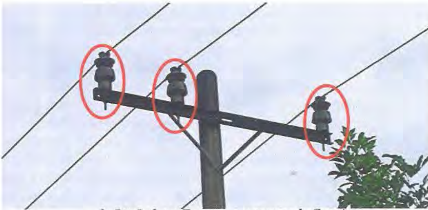
b. Pin Isolator Tumpu terpasang pada CrosArm
