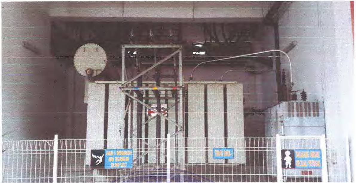
Gambar 2.2: Trafo daya satu step down gardu induk GIS listrik
