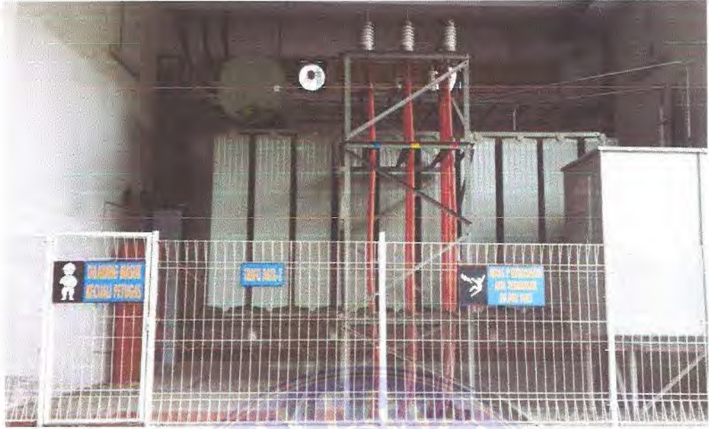
Gambar 2.3: Trafo Daya Dua Step Down Gardu Induk GIS Listrik
