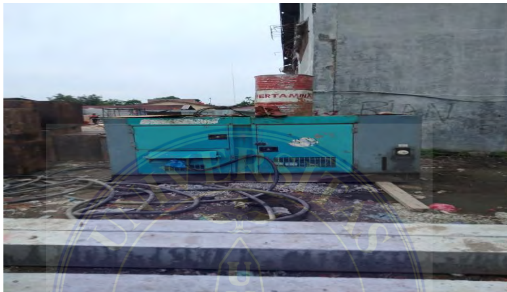
Gambar 3.22 Genset Sumber Data : Lapangan
