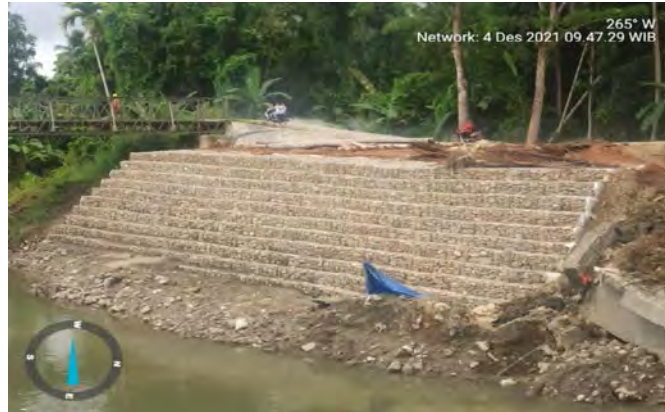
Gambar 4.21. Bronjong pelindung abutment arah Lolowa'u
