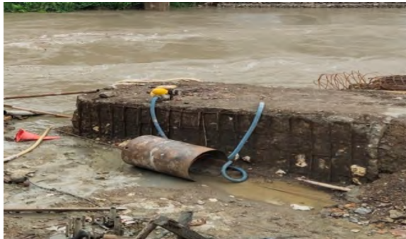
Gambar 3.2. Mesin Pompa Air
