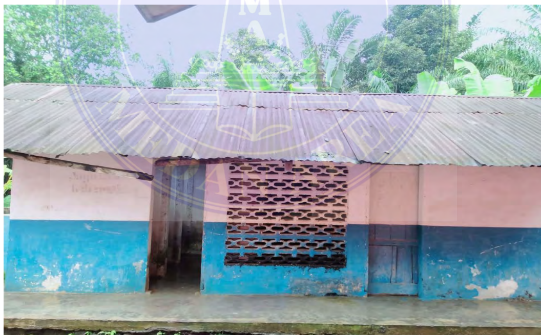
6. Foto toilet sekolah SD Negeri 094124 Dusun Pengkolan (Rabu, 23 Februari 2022)
