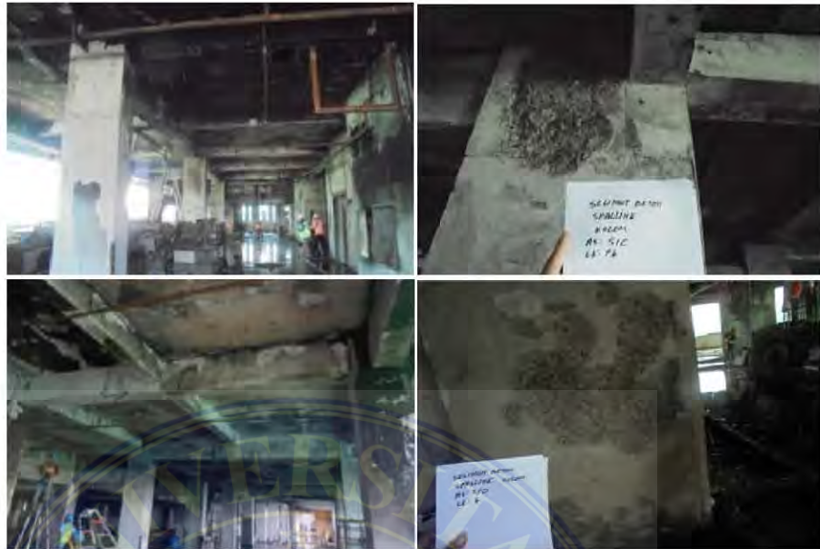
Gambar 3.2. Visual Area Kebakaran dan Kolom di Lt. P6 Pasca Kebakaran
