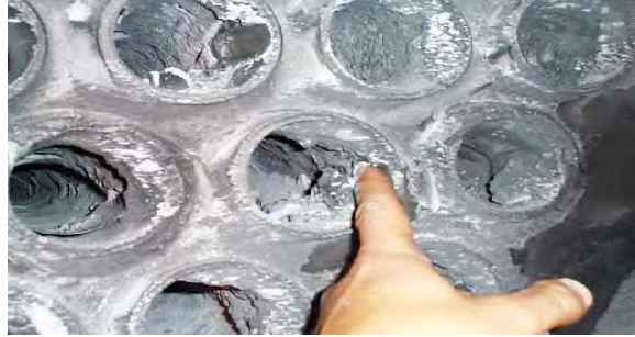
Gambar 2.14. Fouling (pengotoran) pada shell and tube
