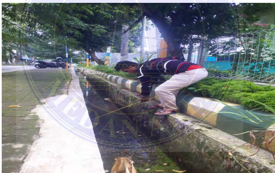
Gambar L3: Kondisi saluran drainase sebelah kanan Kawasan Kampus 1 UMA.
