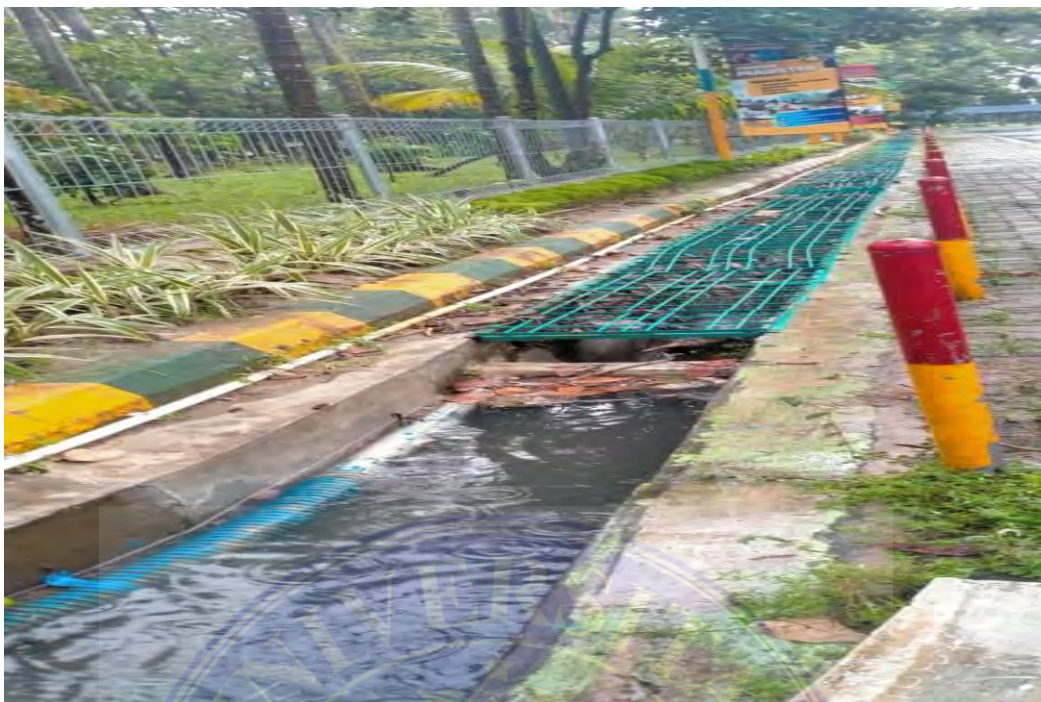
Gambar L6: Gambar kondisi saluran drainase kampus 1 UMA.
