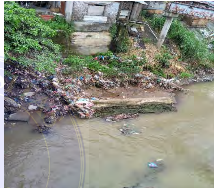
Longsor/Kerusakan dinding Blok Beton Perlindungan Tebing sekitar Jembatan Aloha (Sumber : Data Lapangan)
