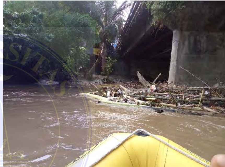
Tumpukan sampah di jembatan (Sumber : Data Lapangan)
