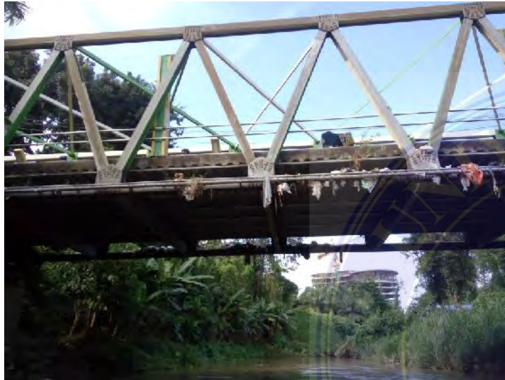
Pembuangan Sampah sampai menyangkut di jembatan Juanda (Sumber : Data Lapangan)
