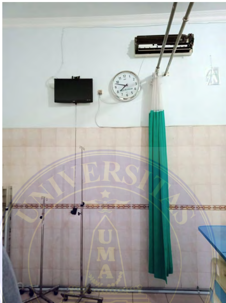
Gambar 10. AC rusak di ruangan sedap malam di RSUD Dr. RM Djoelham Kota Binjai
