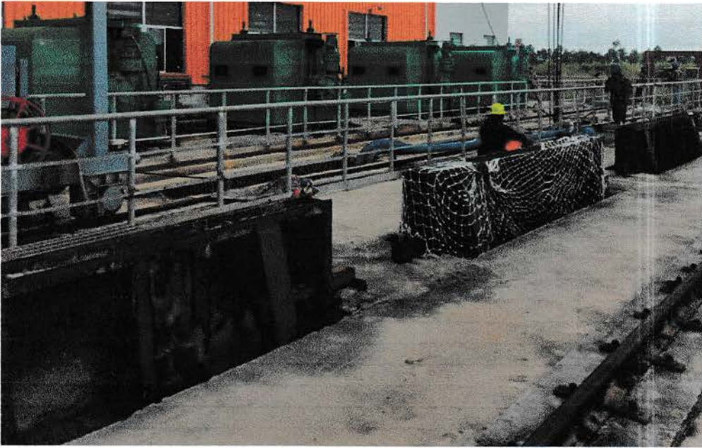
Gambar 3. 9. Traveling Bar Screen di Sisi Intake
