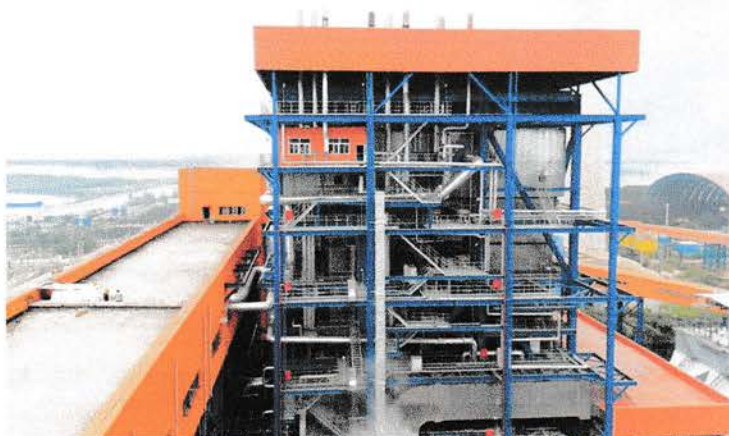
Gambar 3. 2. Boiler PLTU Pangkalan Susu Unit 3&4
