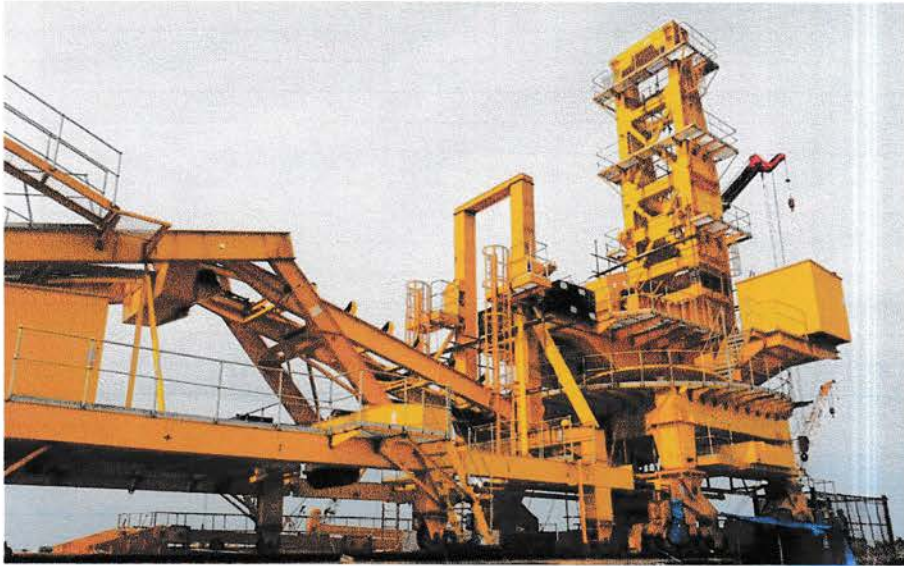
Gambar 3. 10. Stacker Reclaimer PLTU Pangkalan Susu
