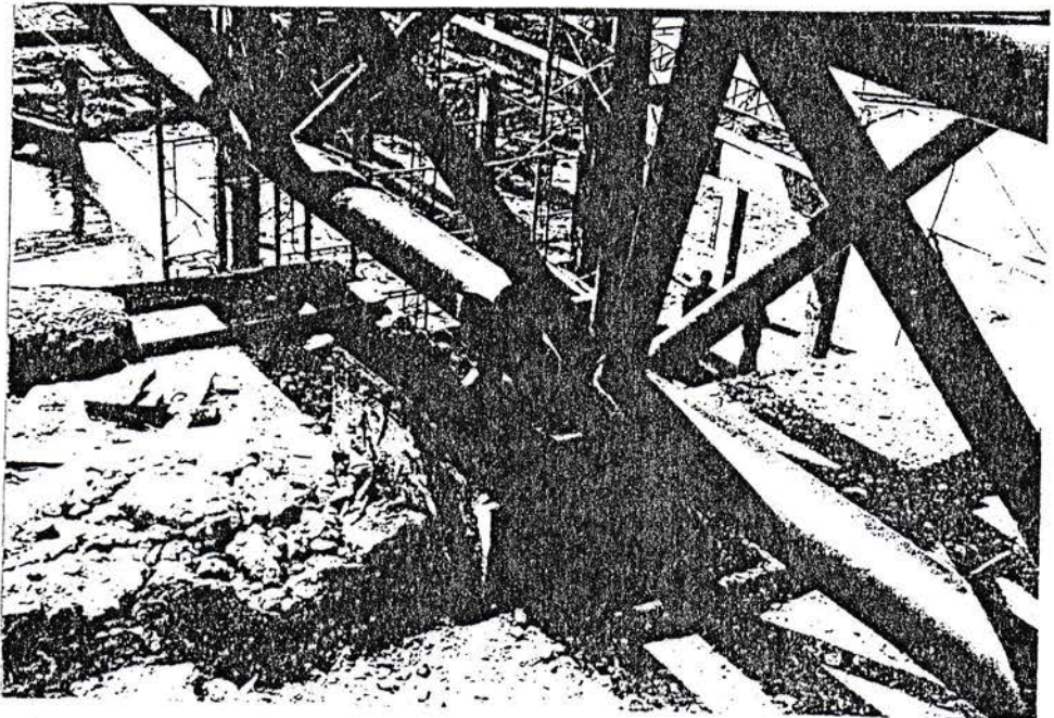
Gambar ; Plat landasan rangka atap restoran diatas penutup lantai 2 bangunan
