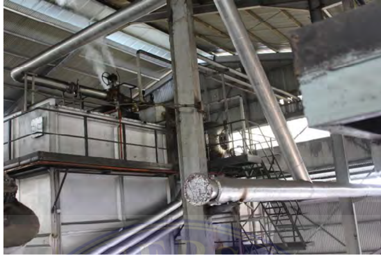
Gambar 3.1 – Pipa Instalasi Uap
