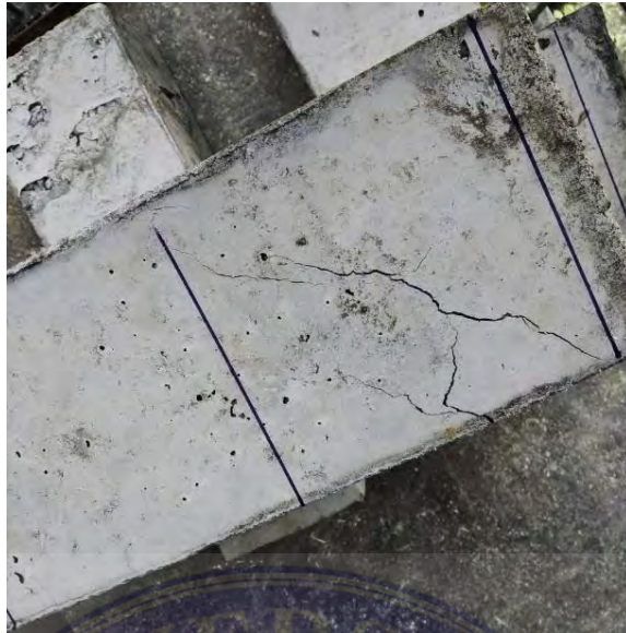
Gambar 4.7 Keretakan balok pada sengkang “U” Sumber: Hasil penelitian
